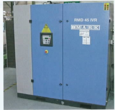
Dank des geringen Geräuschpegels konnte der drehzahlregulierte Kompressor direkt in der Halle installiert werden
